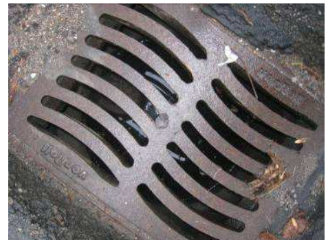
Deckel eines Einlaufschachts
