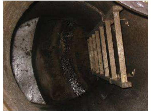
Ein Kontrollschacht mit Einstieg
